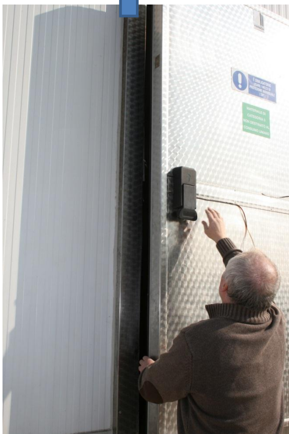
Внешняя дверь холодильной камеры
